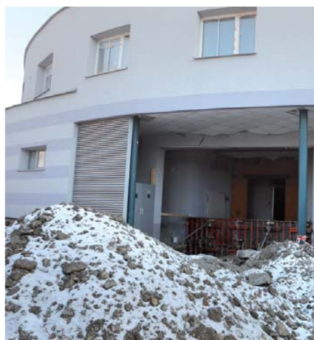
Vjezd do dvora „podkovy“ již neexistuje. Místo něj se připravuje rampa, přes kterou bude probíhat zásobování Bertiných lázní.
