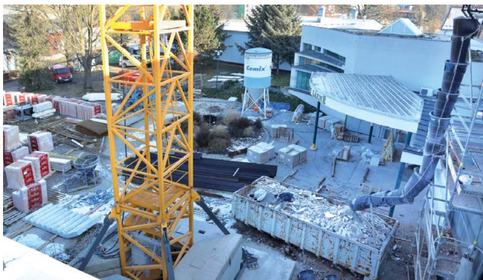
Pohled ze střechy směrem k jižnímu vchodu a k bazénu Bertiných lázní.
